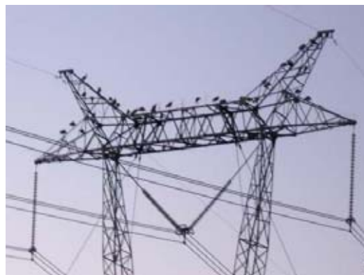
Torre SB com cadeia de isoladores I V I
