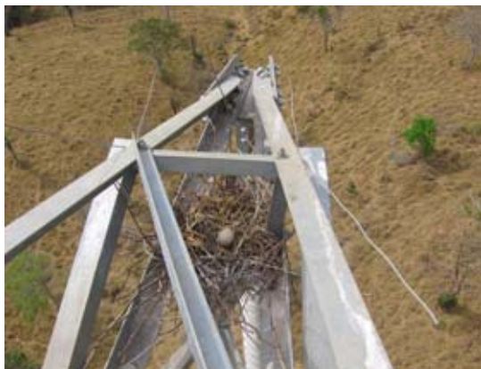
Ninho construído sobre sistema de proteção
