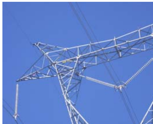
Ninho na viga vertical esquerda
