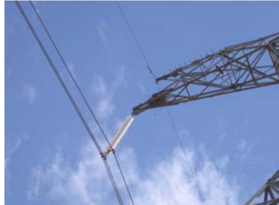
Ninho na mísula próximo à cadeia de isoladores - I
